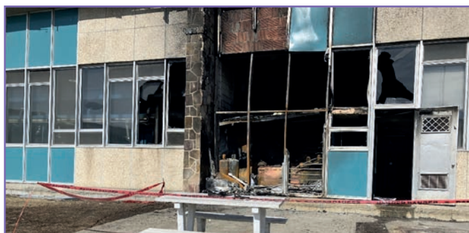
SECTEUR TOUCHÉ PAR L'INCENDIE AU CFP
